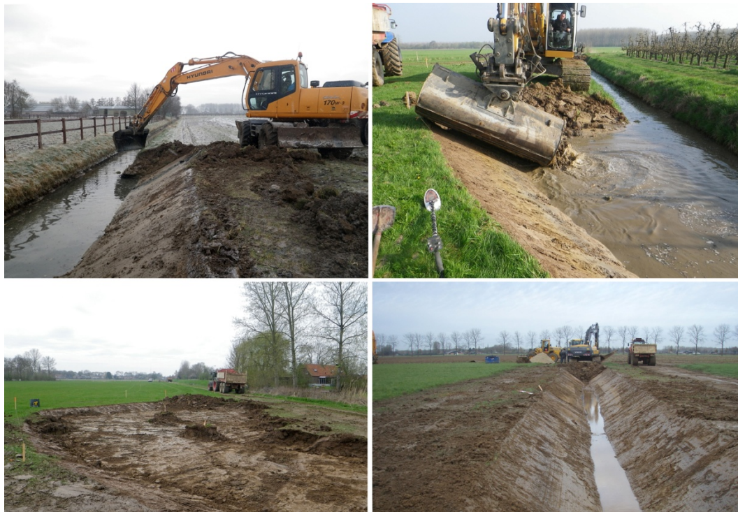
Afb. 5. Verschillende werkzaamheden binnen het Kader RichtlijnWater (met de klok mee vanaf linksboven): het verruimen van bestaande watergangen (links en rechts), het graven van een nieuwe watergang met behulp van een V-vormige bak en het uitgraven van een vispaaiplaats.
